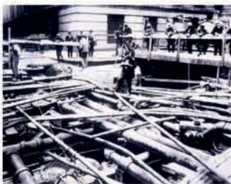
Une photographie, datant de 1918, illustre l'enchevêtrement des réseaux souterrains sous Wall Street, à New York
