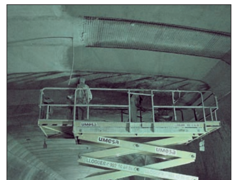
Figure 9 - Protection par mortier réfractaire
