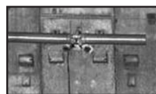
Exemple d'antenne radio sol-train fixée sur un parement de tunnel
