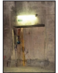
Eclairage d'ambiance par tubes fluorescents (une niche sur trois).
