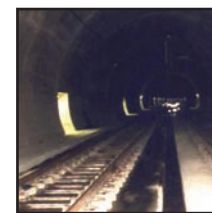
Eclairage d'évacuation par tubes fluorescents disposés dans chaque niche.
