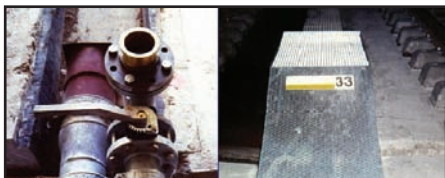
Bouche incendie avec vanne d'ouverture Capot de la bouche d'incendie
