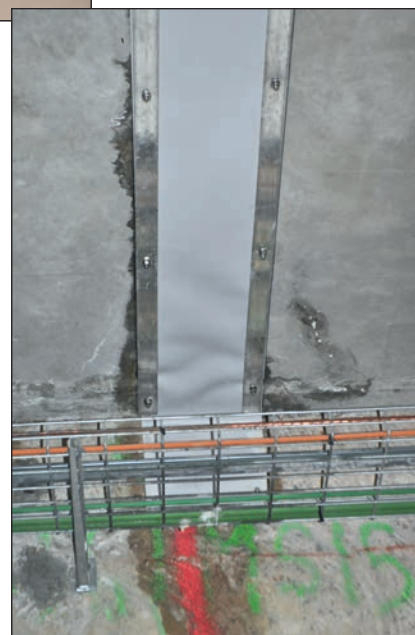
Photo 2 - D/NOX-TBS 11 fixé mécaniquement.
