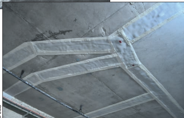
Photo 6 - Fissures suintantes traitées par injection et par pontage D/NOX – TBS.
