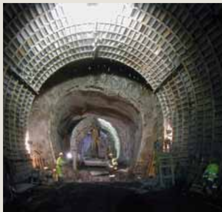
Travaux d'accès au tunnel d'Ambin, marqués par plus de 2 m de convergence diamétrale due à l'excès de contrainte. Les grands tunnels transalpins posent de redoutables problèmes aux géosciences. © Artea
