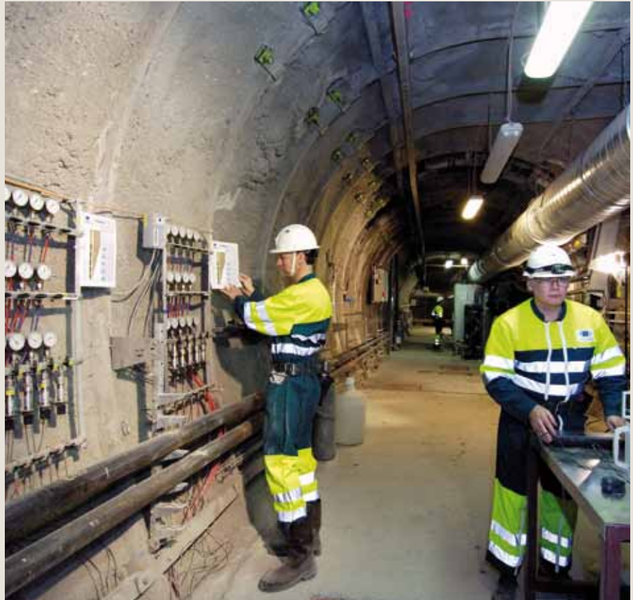
Afin d'étudier le stockage en profondeur de déchets radioactifs de haute activité et de moyenne activité à vie longue, l'Andra a construit à 500 mètres sous terre en Meuse/Haute-Marne un laboratoire de recherche souterrain. © ANDRA / Véronique Paul
